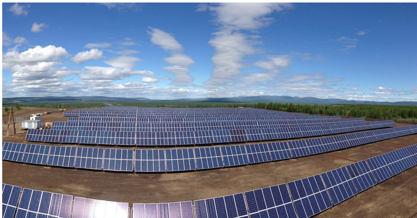
СЭС Батагай — солнечная электростанция, расположенная в посёлке Батагай Якутии. Является крупнейшей солнечной электростанцией за северным полярным кругом. Введена в эксплуатацию 23 июня 2015 года.
